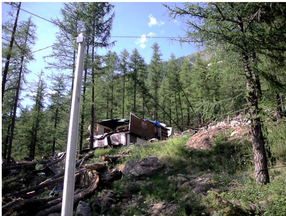
Figura 2.5 - Danni da valanga su edificio: è possibile osservare la completa asportazione della copertura. Ceresole Reale, Piemonte (Chiambretti, 2009).
