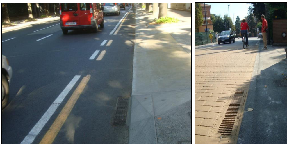
Esempio di interventi pericolosi: Caditoie su corsia ciclabile
